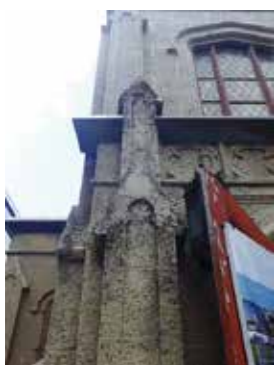
図4-4 尖塔状裝飾壁の汚れ、欠損
