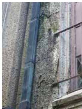
図4-7 東面の雨樋付近の塗材のはがれ
