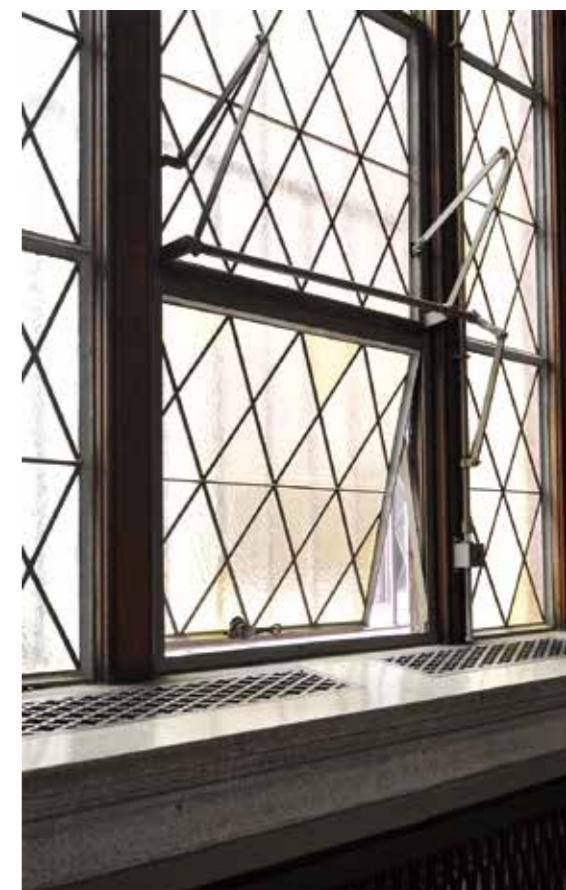
22 側窓開閉装置
