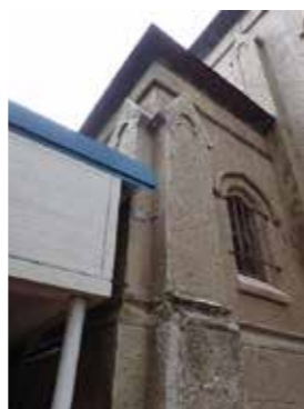
図4-11 南外壁の欠け(上部)
