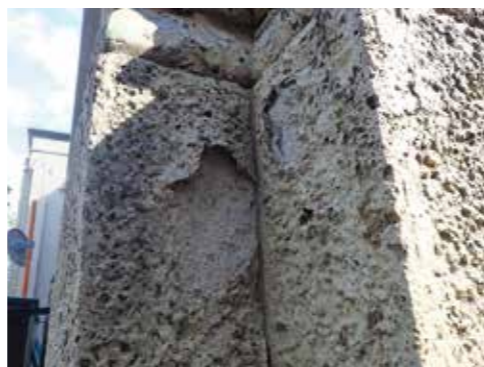
図4-8 西面の樹脂の剥離
