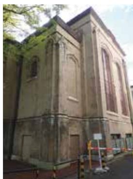
図4-13 北外壁の変色
